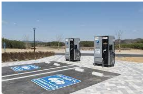
EV充電スタンド
