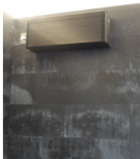
炉前ホールに 取り付けられたエアコン
