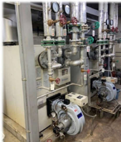
現在設置している真空式温水ヒーター
