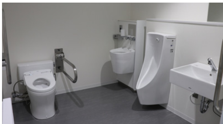
多目的トイレ
