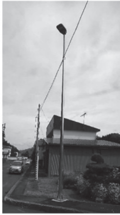
LED道路照明
